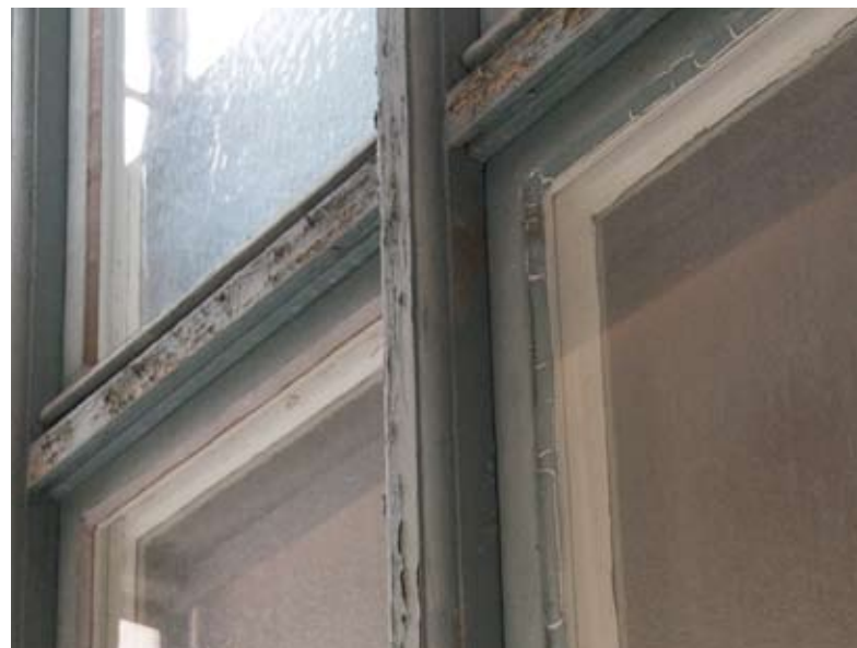
VÄNTAR MAN SÅ HÄR LÄNGE MED UNDERHÅLLET BÖRJAR FUKT OCH RÖTA TRÄNGA IN.
