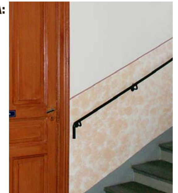
INNAN OMMÅLNINGEN VAR VÄGGARNA SLARVIGT SVAMPNINGSMÅLADE I EN ROSA KULÖR. DÖRRARNA VAR ÅDRINGSMÅLADE, MEN MÅLNINGEN ILLA UTFÖRD.
